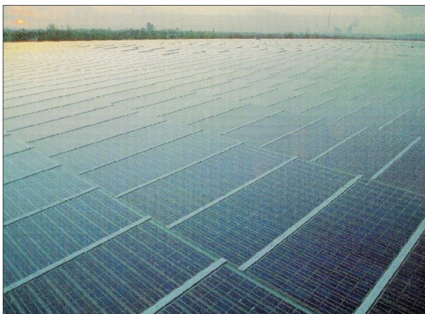
Bild 4. Pilkington-Solar, Solargenerator Herne, 1 MW, 750 MWh/a, 10 000 m 2 Solarzellen
