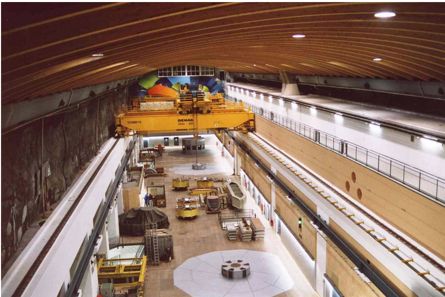
Kraftwerkskaverne Goldisthal (installierte Leistung 1.060 MW)
