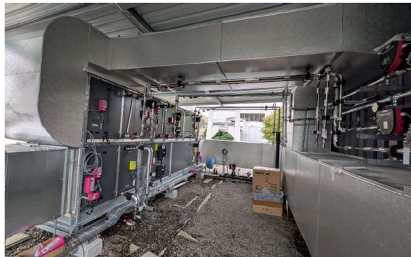
2 Lüftungsanlage mit Kanalsystem und Medienversorgung
